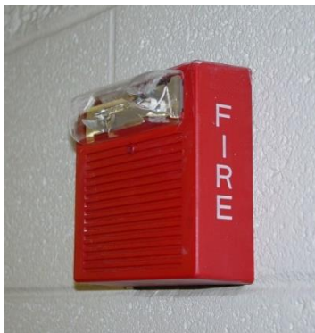
Εικόνα 10. Σύστημα ειδοποίησης πυρκαγιάς (Wheelock AS horn/strobe, Source: Ben Schumin) [48]
